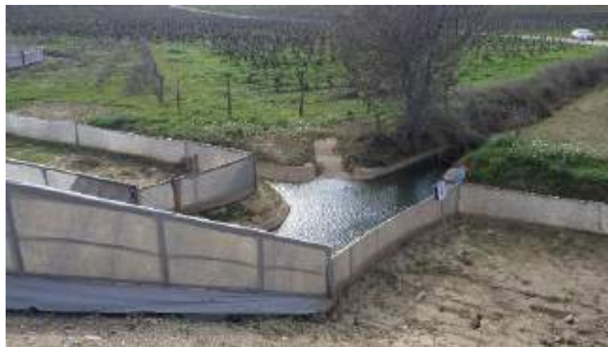
Figure 183 : Clôture anti-intrusion autour d'un cours d'eau - (Source : SOLER IDE
